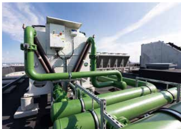
Qua energie-efficiëntie zorgt een BEO-veld en WKK-installatie voor een reductie van het energieverbruik
